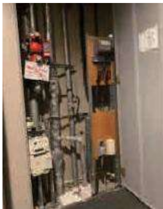
分譲マンション設置例①
